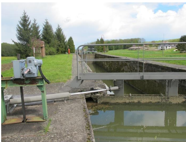
Eclusa gabarito freycinet nivelada ao nível d'água de montante. Canal antigo do Reno ao Ródano. França. Foto de Venâncio Neiva, 2012.
